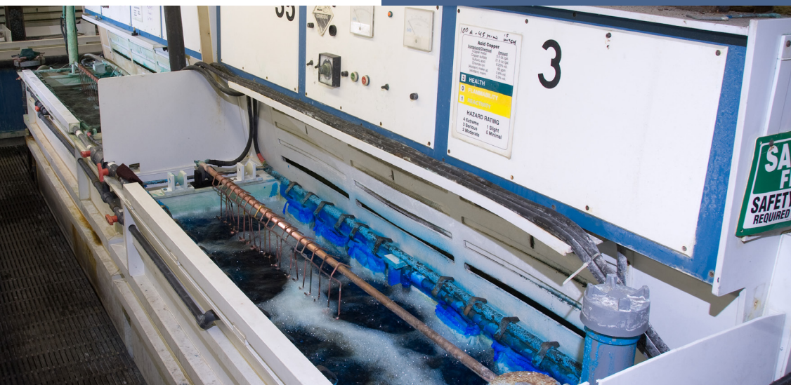
Bains de traitement chauffés en réservoirs plastiques
